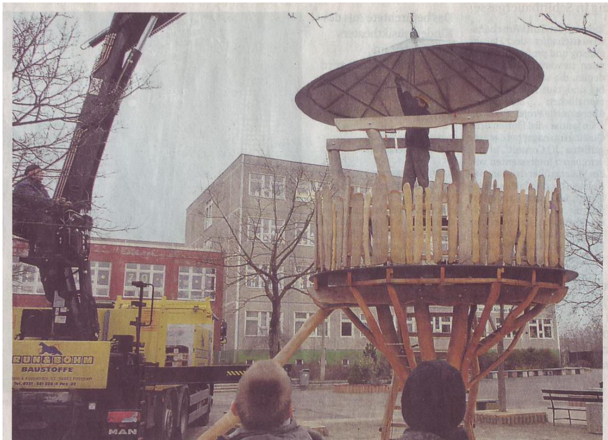
Entscheidender Moment: Jörg Fleischhauer dirigiert den Kran, Mario Mannhaupt positioniert das Dach über der Tragkonstruktion. FOTO: KÖSTER
